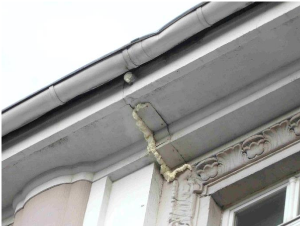
Foto 51: Schaden am Dachüberstand ...
