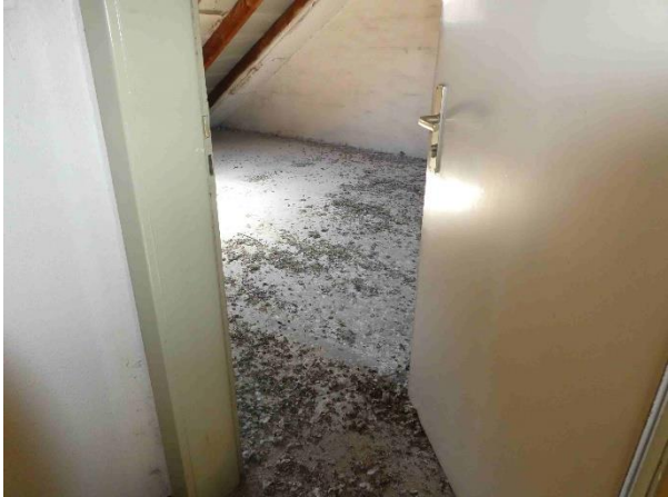
Foto 49: viel Taubenkot spricht für eine längere Nutzungsdauer
