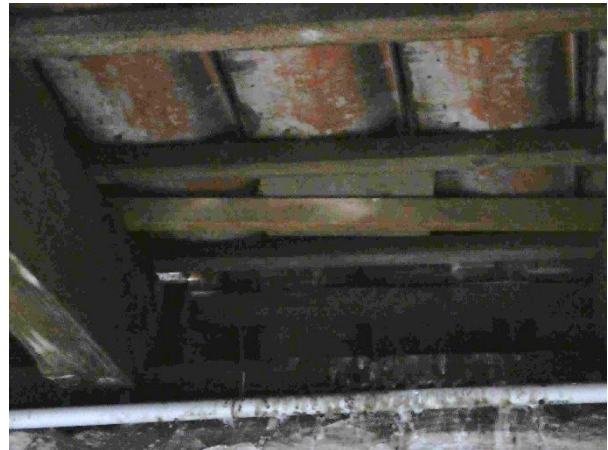
Foto 59: verrutschte Dachpfanne wurde mit einer Latte gerichtet (vgl. Foto 28)
