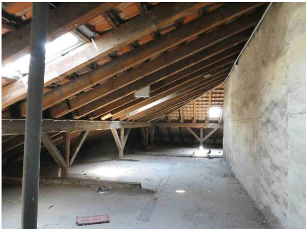
Foto 23: Dachboden nicht gedämmt oder unterspannt
