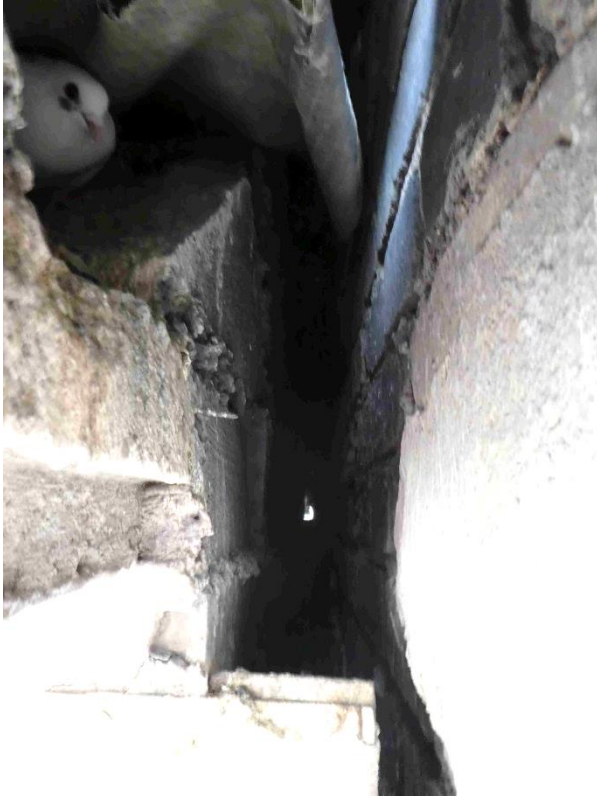
Foto 57: Blick durch den ca. 15 cm breiten Spalt (Bereich Dachgeschoss Wohngebäude) mit Taubenbesatz (l. o.)
