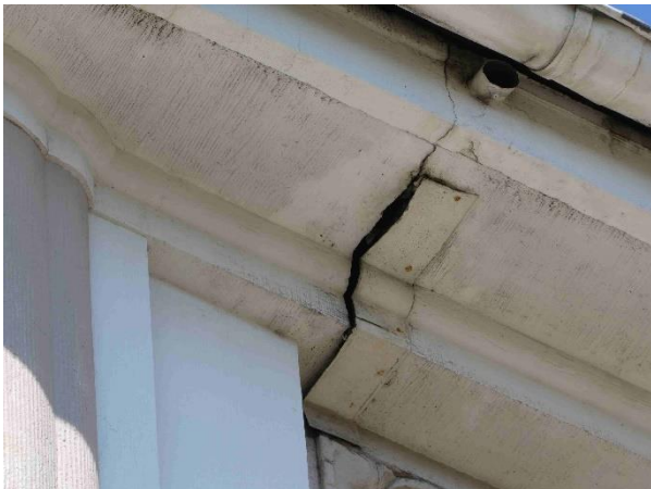
Foto 11: HdB : massive Dachüberstände mit nur einer Schadstelle (Hohlräume können nicht ausgeschlossen werden)
