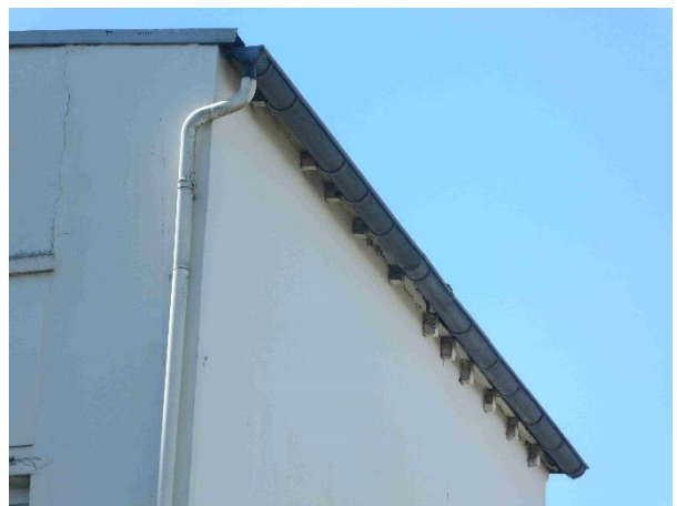
Foto 22: ... und schmalem (intaktem) Überstand des Flachdaches
