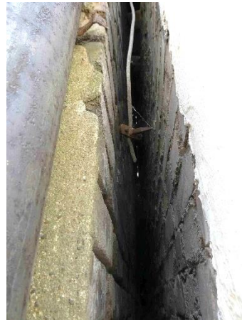
Foto 38: dito: Spalt ca. 10 cm breit; Fuge im Innenhof relativ dicht (geringer Lichteinfall)
