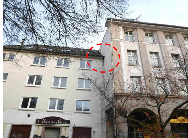
Foto 54: mit Brutgeschehen von Haustauben vorgefundene offene Dehnungsfuge zwischen Wohngebäude (l.) und Haus der Begegnung (r.)
