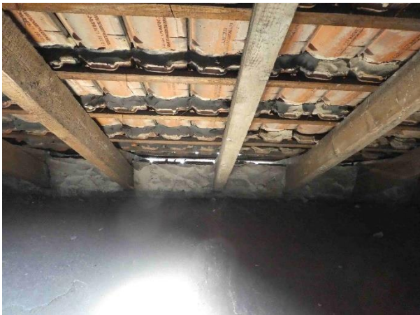
Foto 27: durchlaufender offener Spalt im Bereich der Dachüberstände
