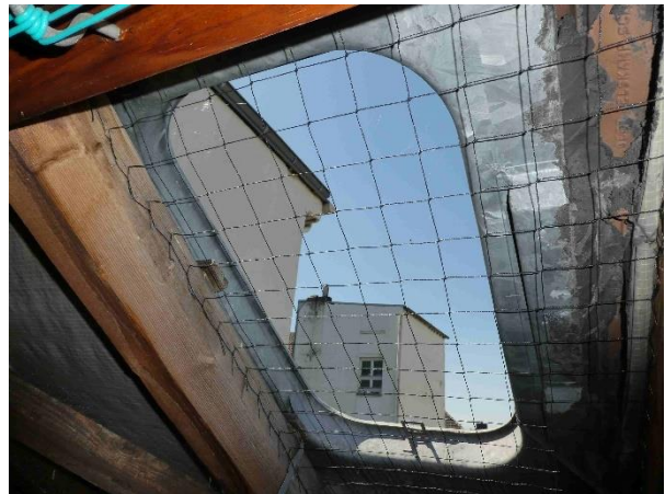
Foto 46: Fenster teils vergittert oder verschlossen, ...
