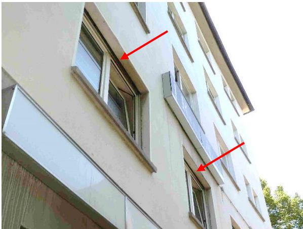
Foto 39: innenliegende Rolladenkästen, teilweise mit breitem Spalt
