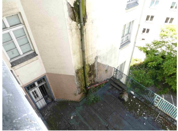
Foto 20: Putz der Fassade bröckelt ab
