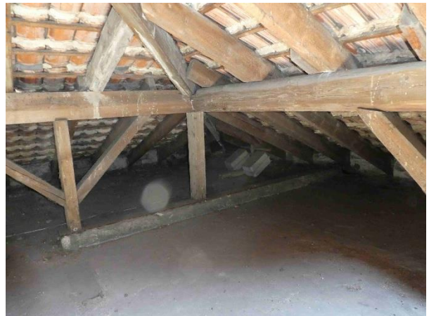
Foto 24: Übergänge zwischen den Dachpfannen meist mit Mörtel verklebt
