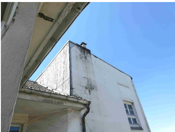
Foto 21: linkes Treppenhaus mit geringfügigen Schäden ...
