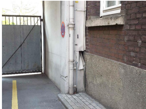
Foto 6: ... durch breite Dehnungsfuge im unteren Bereich getrennt: Abdeckungen defekt
