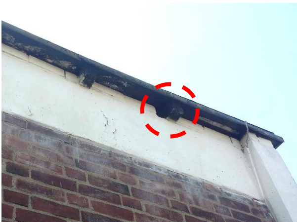
Foto 9: ... kleinflächiger Dachabdeckung (mit pot. Hohlräumen auf Nordseite)
