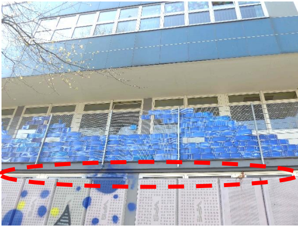
Foto 19: geöffnete Fenster des EG mit Lochblechen nur unzureichend abgedeckt
