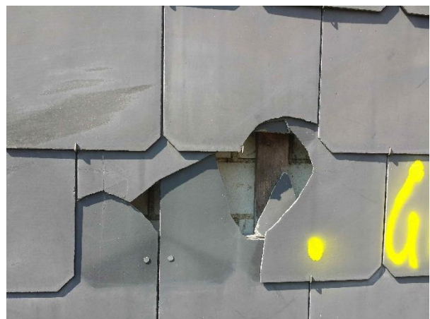
Foto 34: Fassadenverkleidung (vgl. Foto 30) beschädigt (Quartierpotential)
