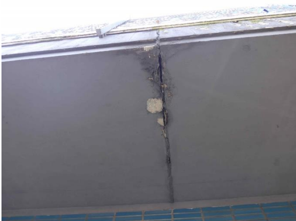
Foto 25: schmale Spalten zwischen horizontalen Betonplatten der Terrasse am HB und mit kleinen Spalten vernässt
