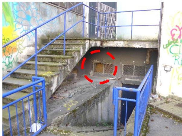
Foto 10: Eckbereich des HB im Innenhof: Zugang zum Keller mit fehlender Fensterscheibe, ...
