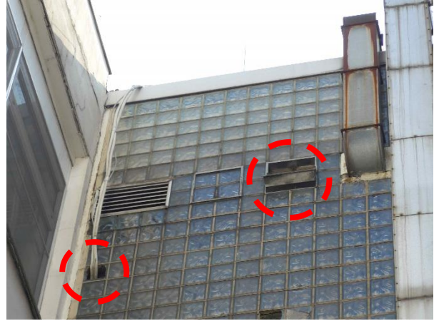
Foto 12: dito; linker Kreis: Öffnung wegen Kabelverlegung → Foto 13; beide Kreise: Einflug für taubengroße Vögel nicht möglich
