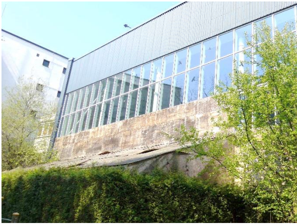
Foto 17: Fensterfront mit Spanplatten vor Vandalismus geschützt; davor dichte Heckenpflanzung auf ganzer Länge
