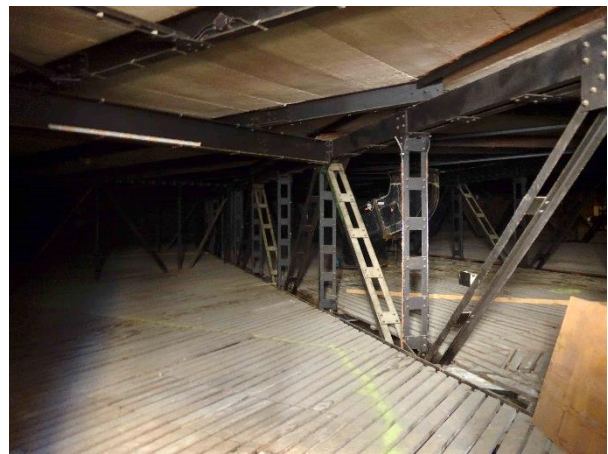
Foto 38: Raum über abgehangener Decke des Badebereiches ohne Öffnung
