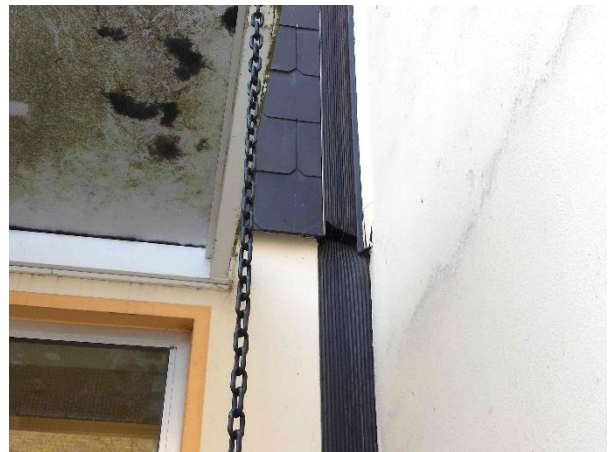
Foto 32: Hohlräume hinter Abdeckung nicht ausgeschlossen
