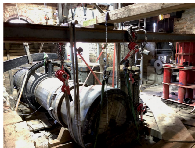
Sicherung der Hammerwelle zum Ausbau des alten und Einbau des neuen Hammergerüsts, die alten Hammersäulen stehen noch, 2019 © Achim Mikuscheit/Ruhr Museum
