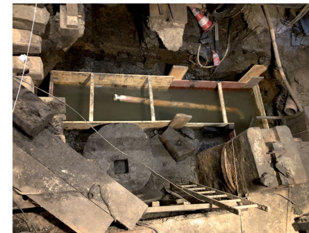
Schalung zum Gießen eines Betonfundaments für die neuen Hammersäulen, 2022 © Achim Mikuscheit/Ruhr Museum
