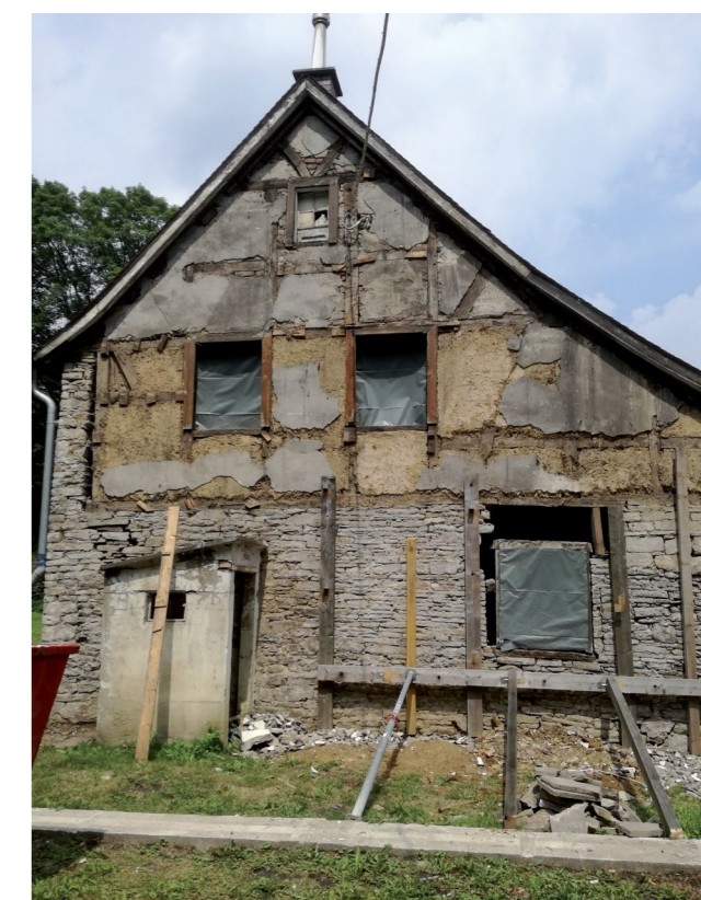
Abbildungen S. 16: Arbeiterhaus um 2011, Süd- Ostseite Arbeiterhaus um 2011, Nord- Westseite Arbeiterhaus auch um 2011, mit Sicherungsgerüst, Süd-Ostseite
