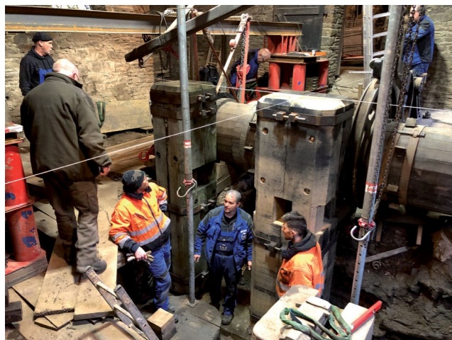
Exakte Platzierung der neuen Hammersäulen in der Baugrube durch die Fa. Nockemann, 2022 © Achim Mikuscheit/Ruhr Museum
