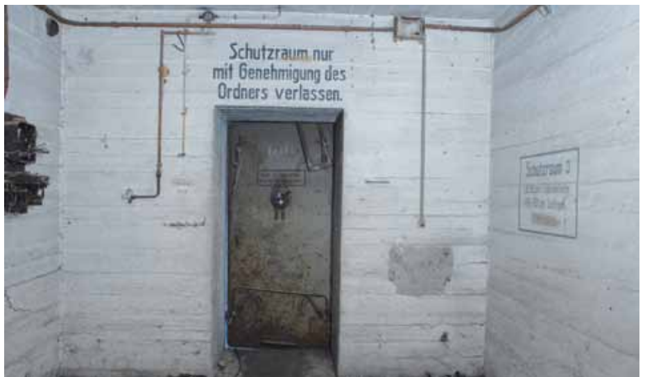
Gasschutztür (Foto: D. Hopp)
