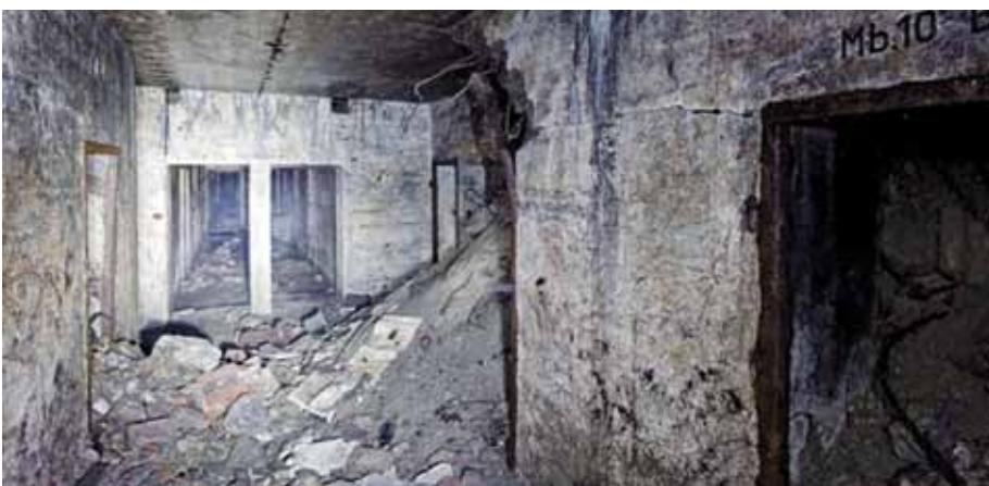
Zerstörungen in der Anlage (Foto: D. Hopp)
