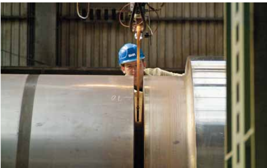
Mit der Planung, Lieferung und Montage von Kraftwerkskomponenten und kompletten Rohrleitungsanlagen ▲ ist BHR Hochdruck-Rohrleitungsbau weltweit aktiv.
