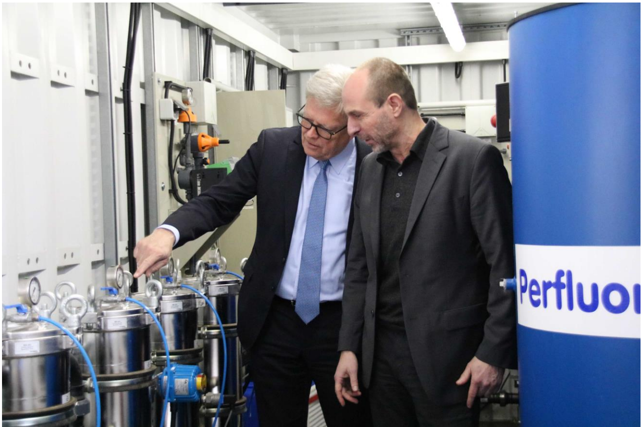
Martin Cornelsen (r.), Geschäftsführer der Cornelsen Umwelttechnologie GmbH, präsentiert EWG-Geschäftsführer Dr. Dietmar Düdden das mobile PerfluorAd-System in Containerbauform zur Reinigung PFC-belasteter Wässer. Foto: EWG
